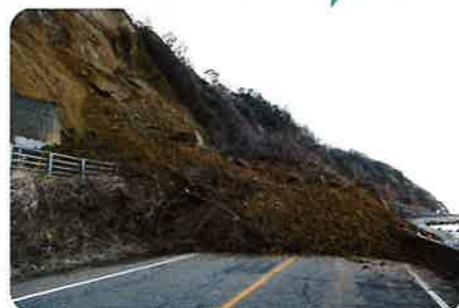
国道8号線 茶屋ヶ原で土砂崩れが発生 道路が不通に
